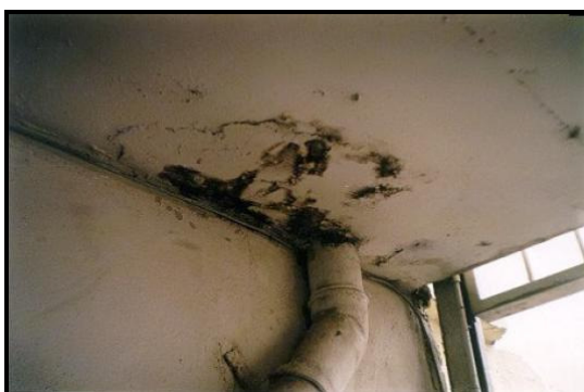
Figura 2.5 - Formação de mofo e degradação da pintura e do revestimento – MORAES (2002).
