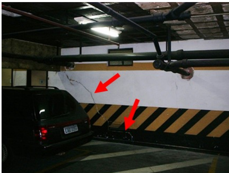
Figura 3.19 – Trinca em alvenaria de vedação no 1º piso da garagem.
