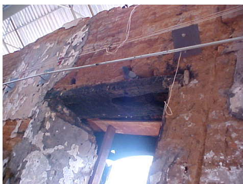
Foto 7.5 - Vergas queimadas (interior do consistório)
