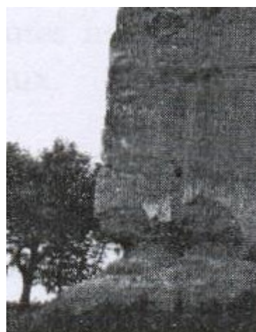
Foto 5.2 - Erosão no soco da muralha de Taroudannt, Morocco
