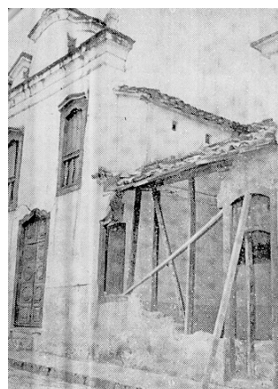
Foto 5.12 - O colapso do frontispício da igreja de N.S. da Abadia em Goiás.
