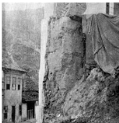
Foto 5.11 - Detalhe de maciço após o colapso da estrutura
