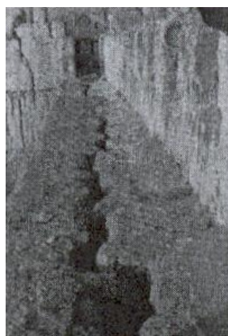
Foto 5.1 - Fendas na muralha de Taroudannt, Morocco
