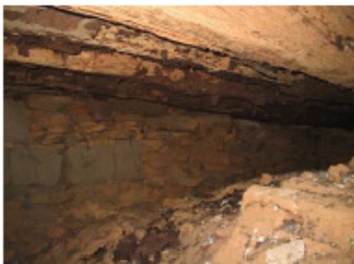
Foto 7.7 - Vergas da porta lateral esquerda, acima do arco de tijolos
