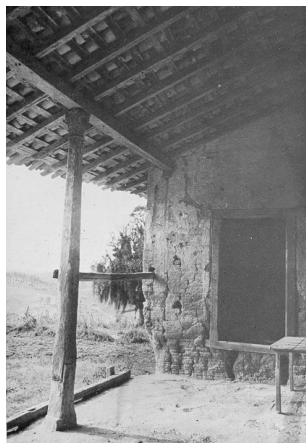
Foto 5.3 - Erosão no soco da casa bandeirista “Calu”
