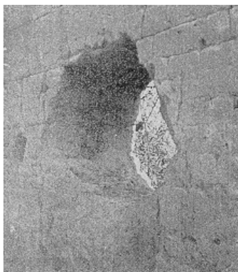
Foto 5.6 - Buraco aberto pelo cupim em uma parede de taipa, Taubaté
