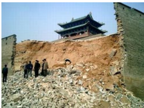
Foto 4.1 - Uma seção da muralha de 17,3 m de comprimento desmoronou.
