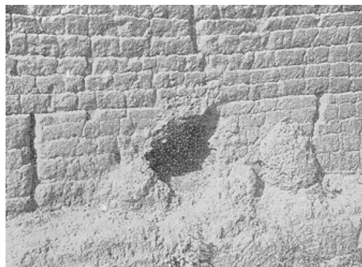
Foto 5.7 - Buraco aberto pelo cupim em uma parede de taipa
