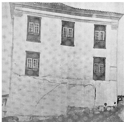
Foto 5.9 - Seqüência do colapso da Matriz do Pilar em Ouro Preto
