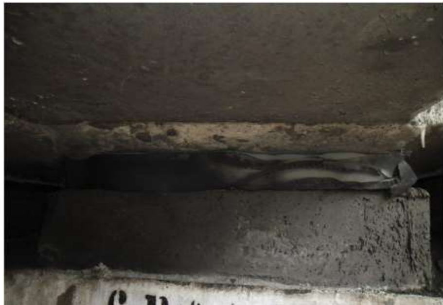
Figura 5.3 – Aparelho de apoio com rompimento da camada de recobrimento lateral, porém, sem trazer vínculos negativos às estruturas adjacentes.
