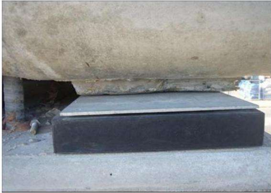
Figura 5.2 – Apoio parcial da almofada de elastômero deixando livre metade da superfície do apoio, sobrecarregando a outra parte.
