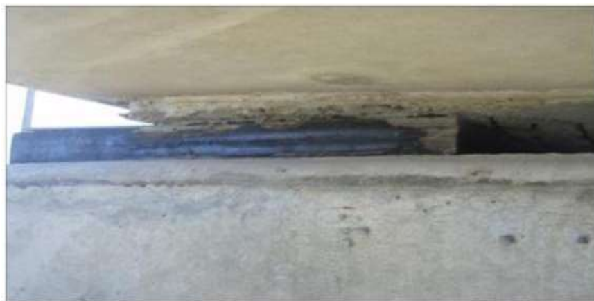
Figura 5.1 – Deformação excessiva da metade do apoio carregada, com falta de condição de apoio da outra metade.
