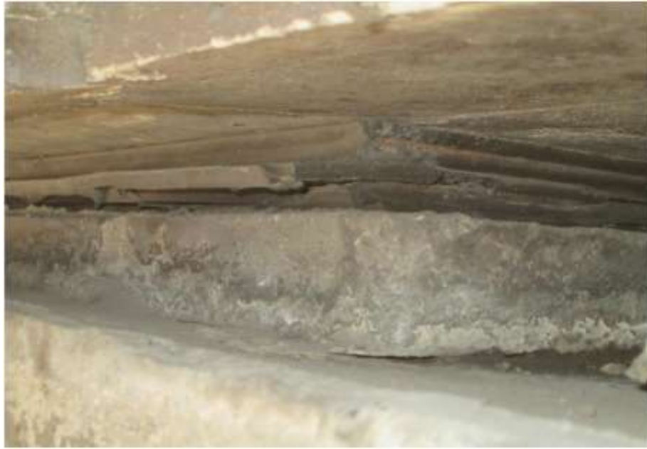
Figura 5.4 – Aparelhos de apoio com fretagem exposta, porém, sem comprometimento das estruturas adjacentes.
