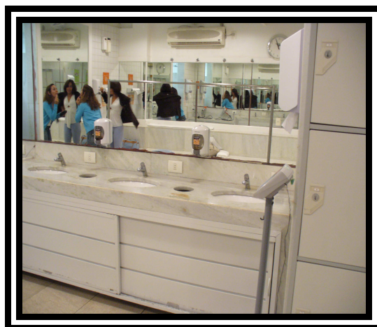
Figura 19 – Banheiro feminino sistema
